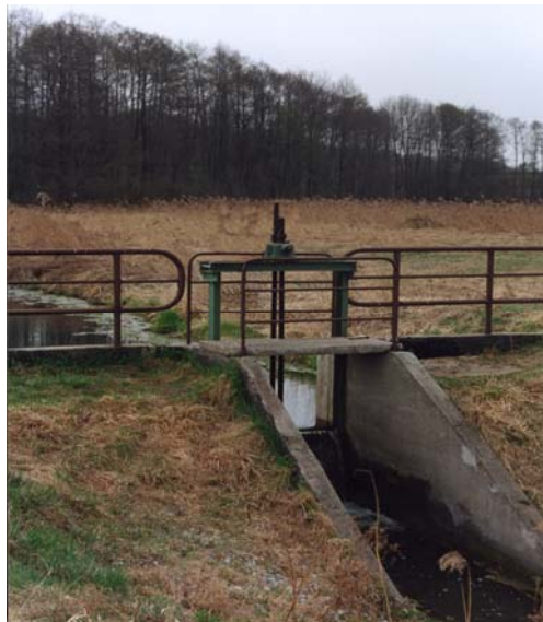
Fot. 4. Urządzenie do regulowania odpływu w Miękinia Phot. 4. Device for regulating the outflow in Miękinia Town
