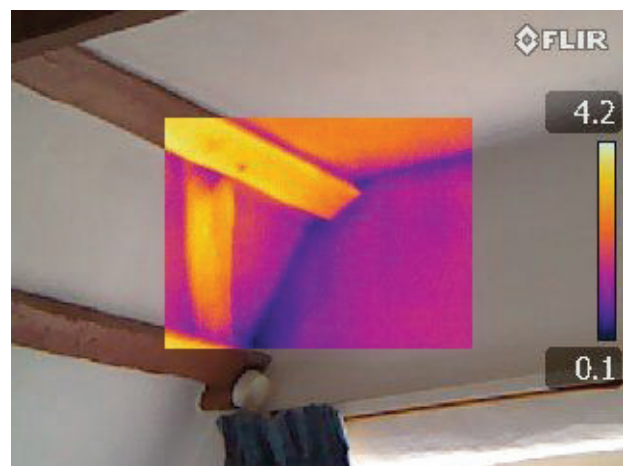
Il. 6. Wewnętrzna temperatura ścian w zimie mogła być bliska 0°C (4.02.2015 przy temperaturze na zewnątrz -5°C) (fot. M.M. Kołakowski)
