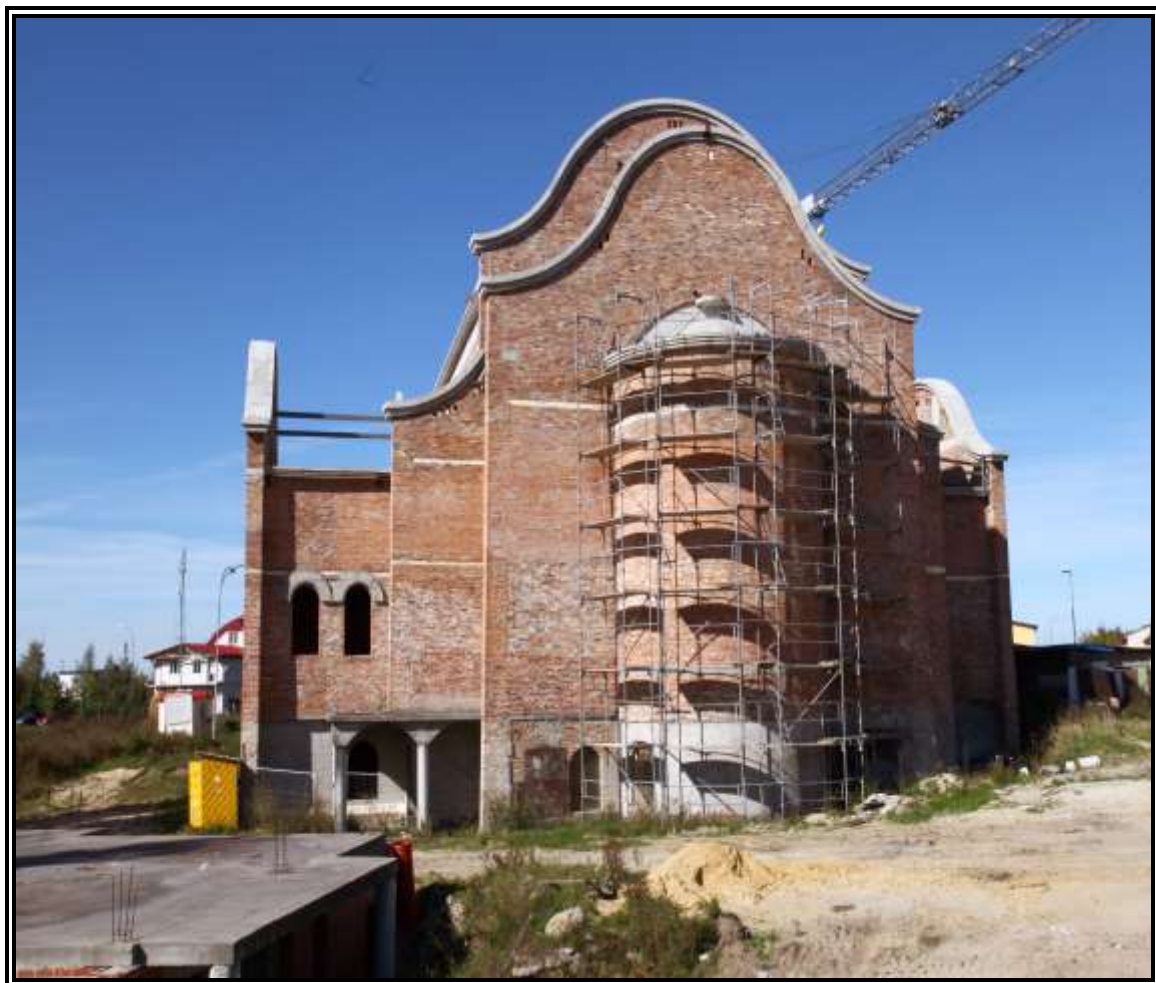
Fot. 3.5.33. Budowany kościół pod wezwaniem Matki Boskiej Łaskawej w Polkowicach. W lewym dolnym rogu fundamenty domu parafialnego. 2014 rok (fot. autor pracy)
