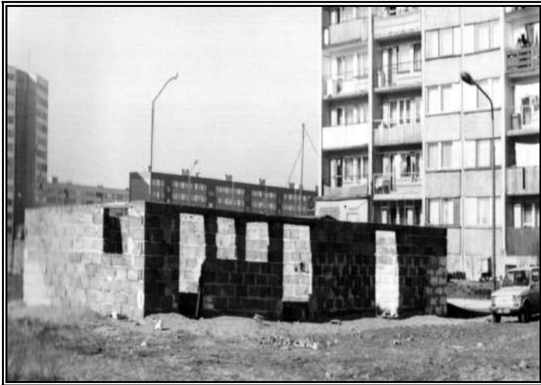
Fot. 3.5.9. Budowa tymczasowej plebanii parafii pod wezwaniem Matki Bożej Królowej Polski w Polkowicach, 1991 rok (archiwum parafii pod wezwaniem św. Michała Archanioła w Polkowicach)
