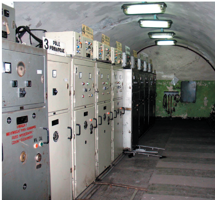
Ryc. 4. Dołowa rozdzielnia 6 kV z polami typu RSK 6
