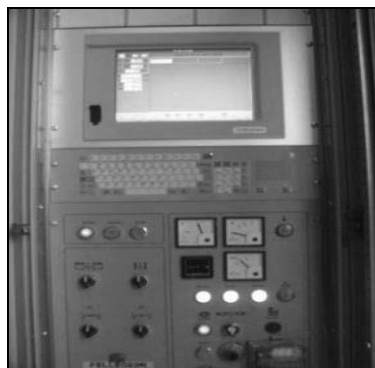
Rys. 5. Panel sterujący (fot. K. Fuławka) Fig. 5. The control panel (fot. K. Fuławka)
