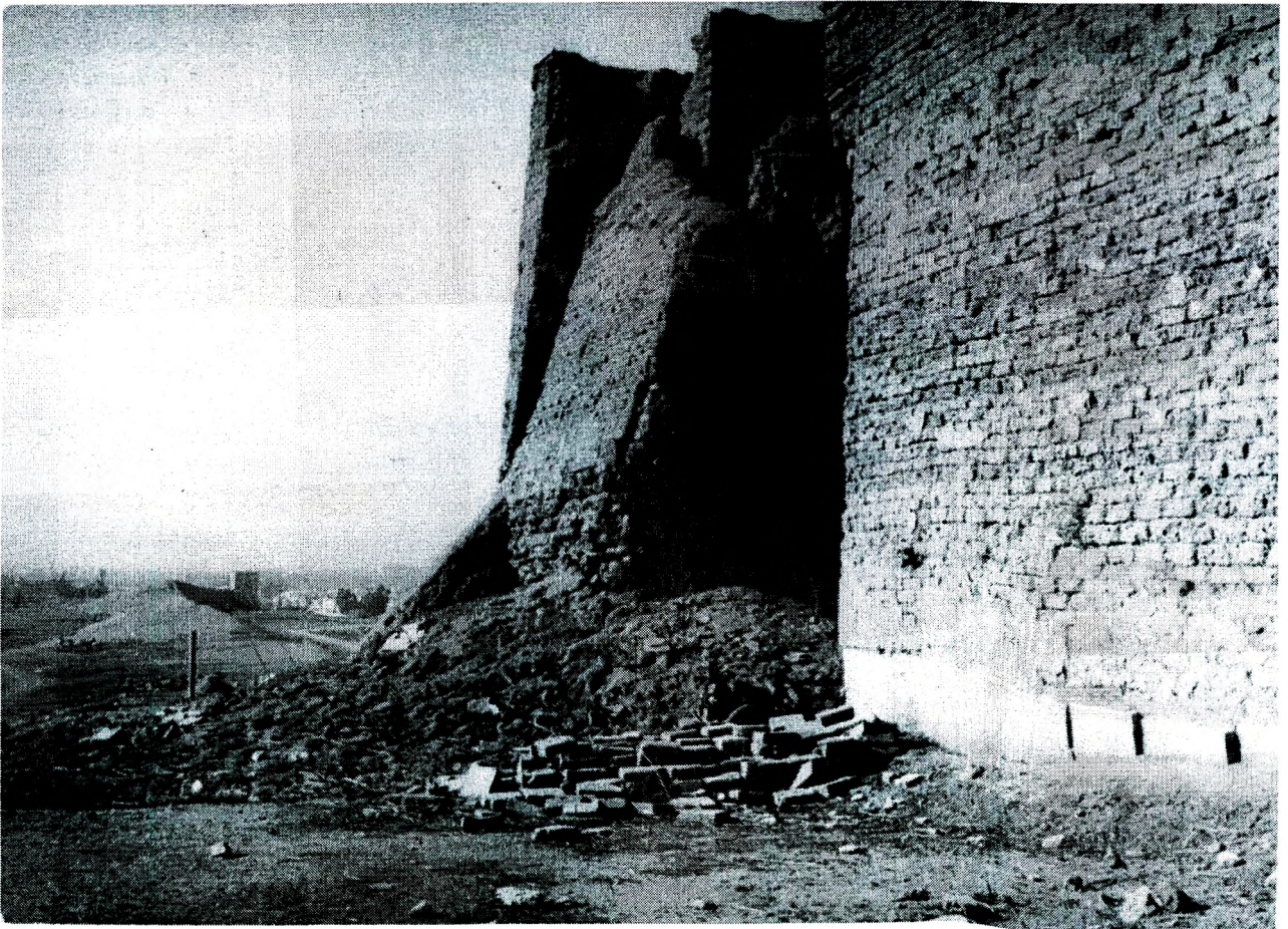
Ryc. 22. Zawalenie się nowo zrekonstruowanych murów zespołu bramy Adada. Suszona cegła (bez konstrukcji szkieletowej) nie wytrzymała ciężaru murów (fot. autora, 1982)
