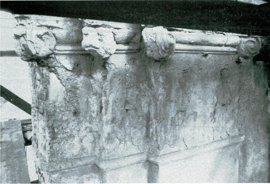
Ryc. 3. Zniszczone głowice pilastrów w szczycie fasady
