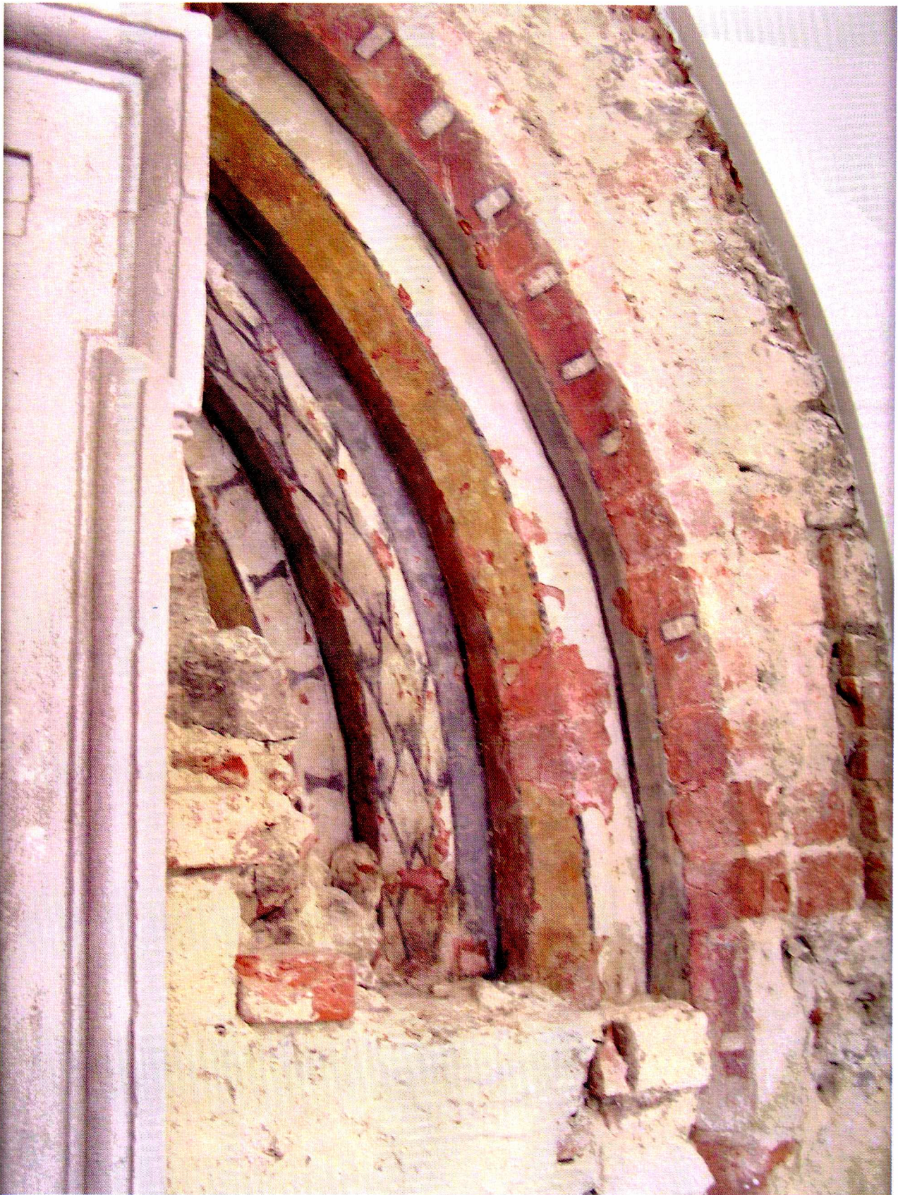
2 Ryc. 6. Polichromie architektoniczne kapitułarza odkryte częściowo podczas badań w 2006 r.: przeźrocze południowe (1) i północne (2) Fig. 6. Chapter house architectonic polychromies partly discovered during investigations in 2006, south (1) and north (2) open-works
