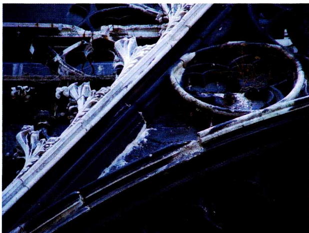
Ryc. 9. Szkody spowodowane przez porost roślinności Fig. 9. Damage caused by plant overgrowth
