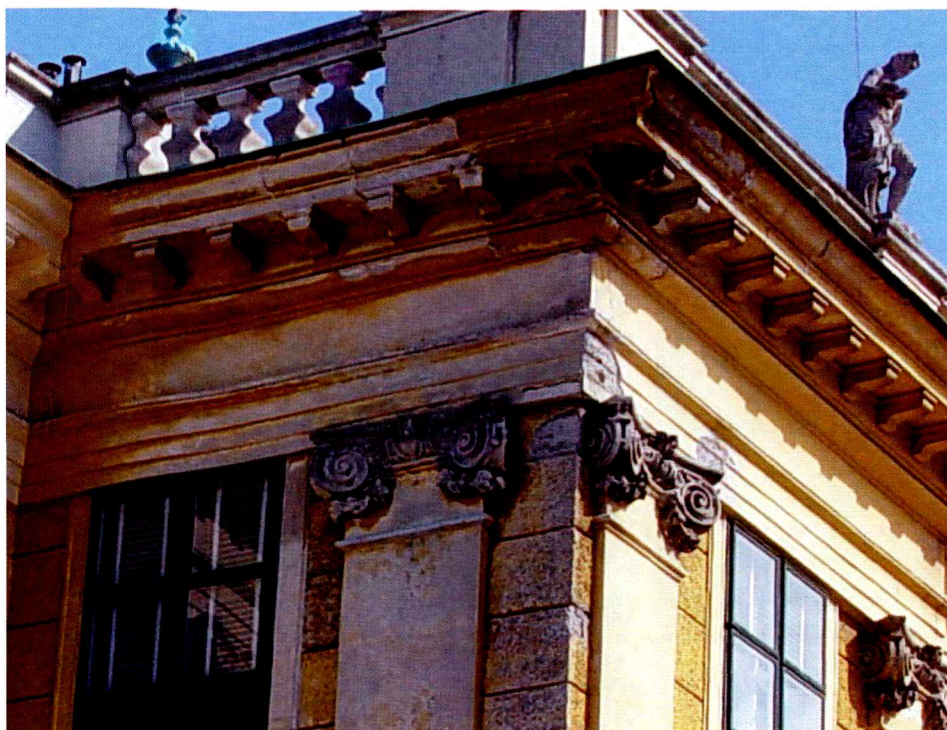
Ryc. 3. Odbarwienia fasady spowodowane działaniem atmosfery
