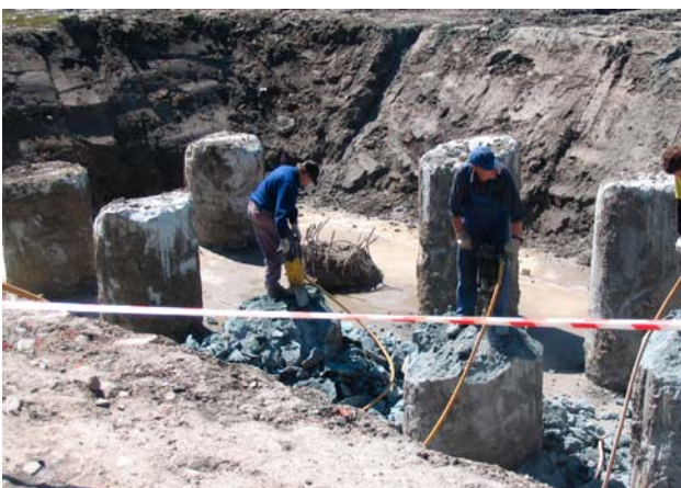
Fot. 3. Pale wielkich średnic, na których posadowiona zostanie podpora środkowa obiektu mostowego
