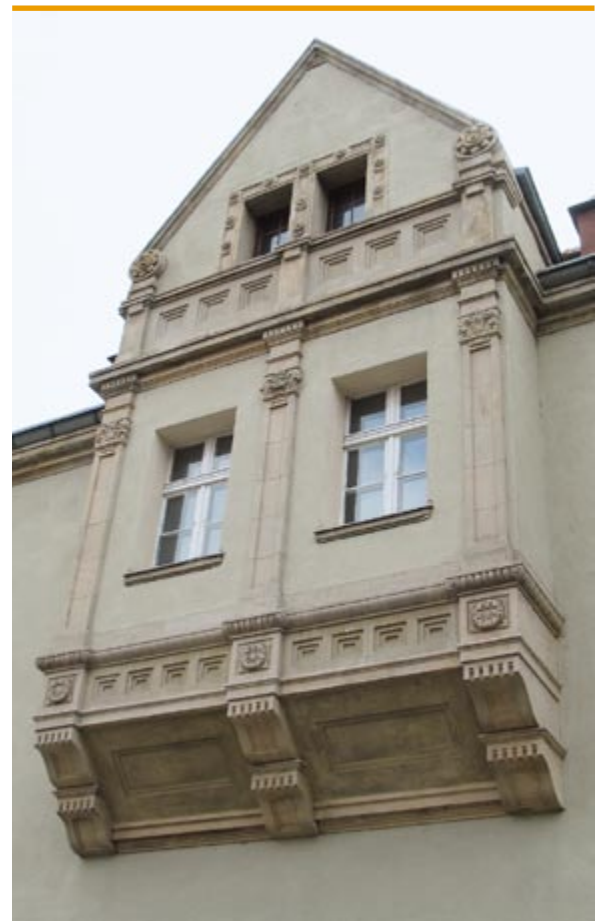
Wykus w elewacji zachodniej
