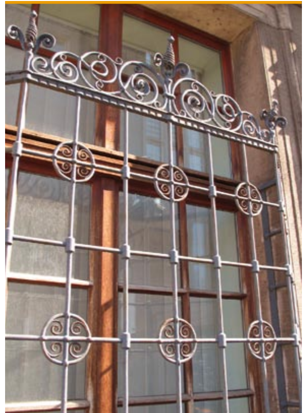
Krata ochronna w oknie elewacji południowej
