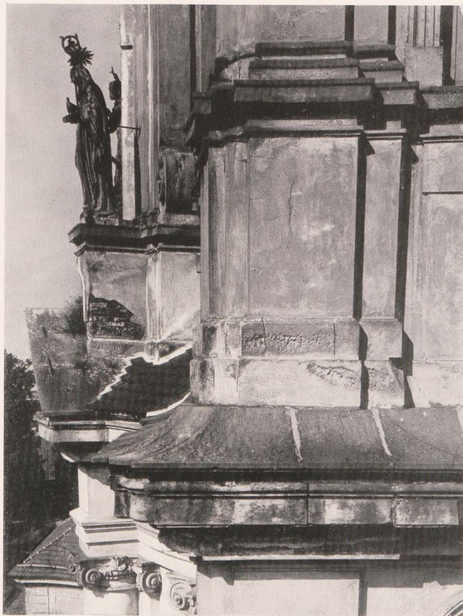
110. Wahlstatt, Klosterkirche. Putzschäden an der Front
