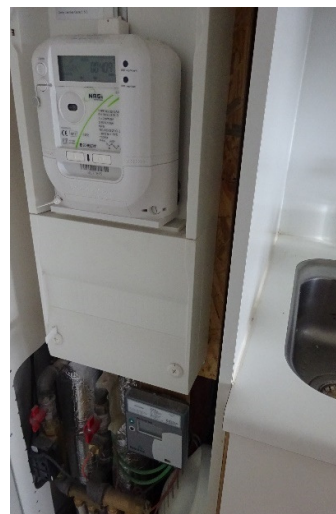
Rys. 18 Szacht instalacyjny w akademiku. Fot. Mokrzecka M.
