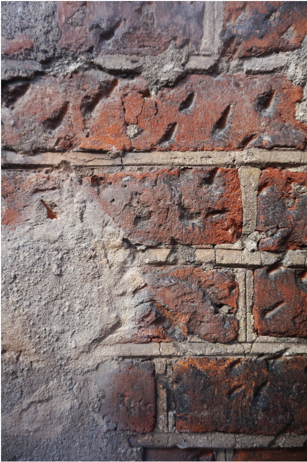
Il. 4. Fragmenty zachowanego tynku i nasieki na ceglach na ścianie południowej transeptu kościoła Mariackiego w Gdańsku – relikty po zegarze słonecznym wschodnim przy środkowym oknie (fot. A. Piwek, 2018)
