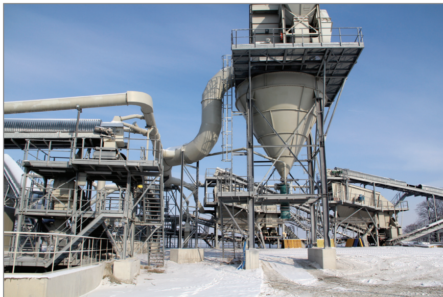
Fot. 14. Układ odpylania Berger Surowce Sp. z o.o. – Zakład Górniczy Wieńnica, woj. dolnośląskie (fot. T. Wojtaszek)
