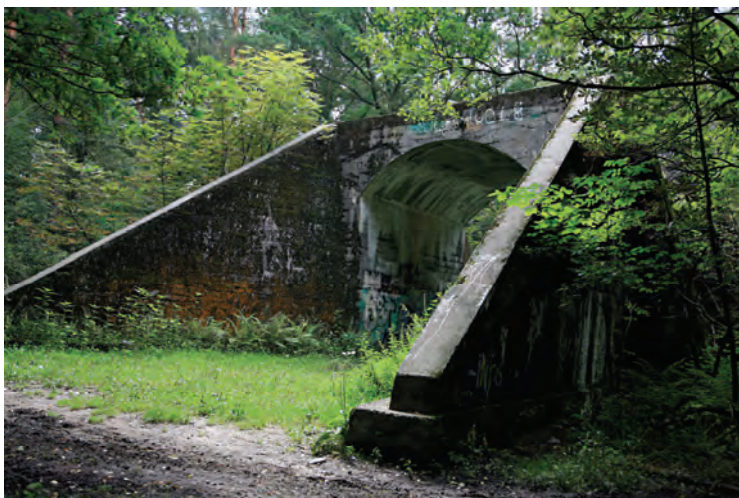
Ryc. 2. Pozostawiony w lesie wiadukt kolejowy po niedokończonej bocznicie kolejowej Fig. 2. The railway viaduct used to build unfinished sidetrack left in the forest
