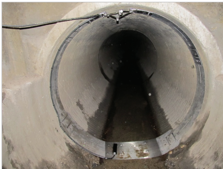
Rys. 3.8. Przepływomierz P2 typu Teledyne ISCO seria 2100 zamontowany w studzience nr 239 na kolektorze KD1 o średnicy 1,2 m (przenośny, zasilany bateryjnie)
