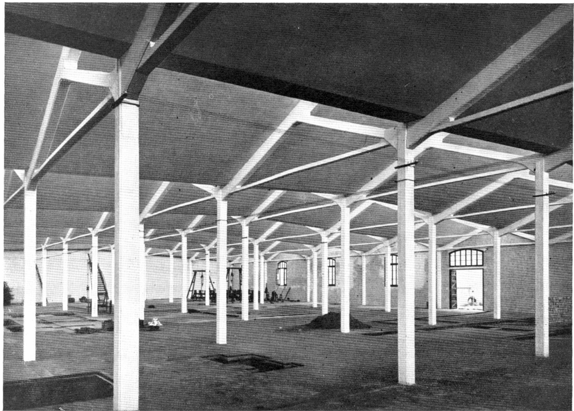
Abb. 75. Fabrik Pirelli, Villanueva. Sheddach mit Zugband. (Maillart & Cie., Genf) Abb. 76. Fabrik Pirelli, Villanueva. (Maillart & Cie., Genf)
