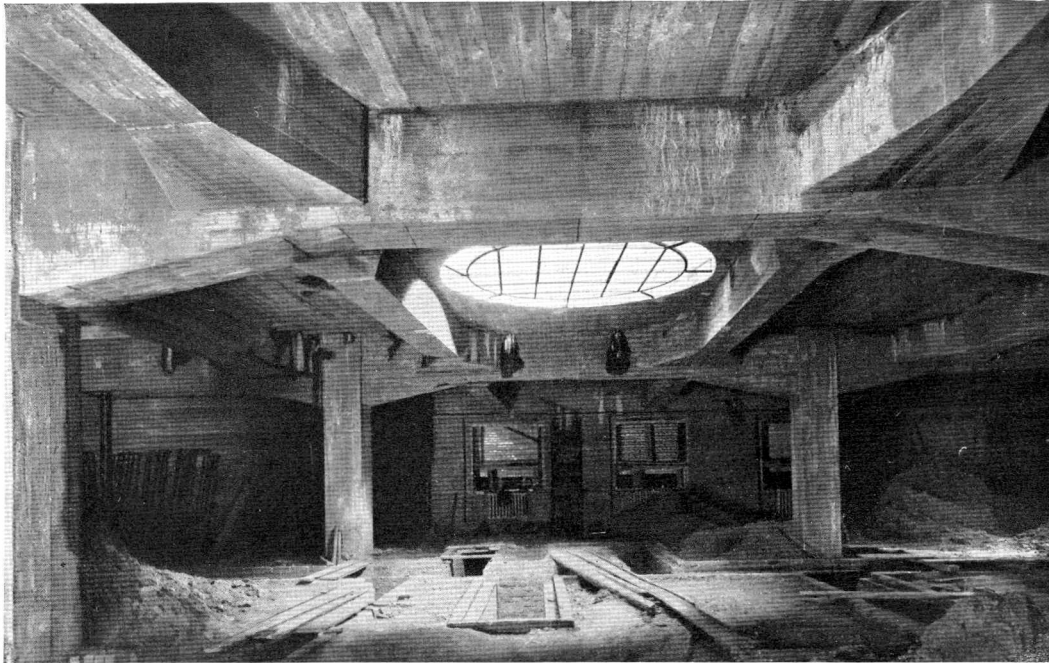
Abb. 64. Ernst Schmolz: Ullsteindruckhaus, Berlin-Tempelhof. Decke über der Küche. Die Balken sind zur Verringerung der Konstruktionshöhe an den Auflagern verbreitert. (Beton- und Monierbau A.-G., Berlin)
