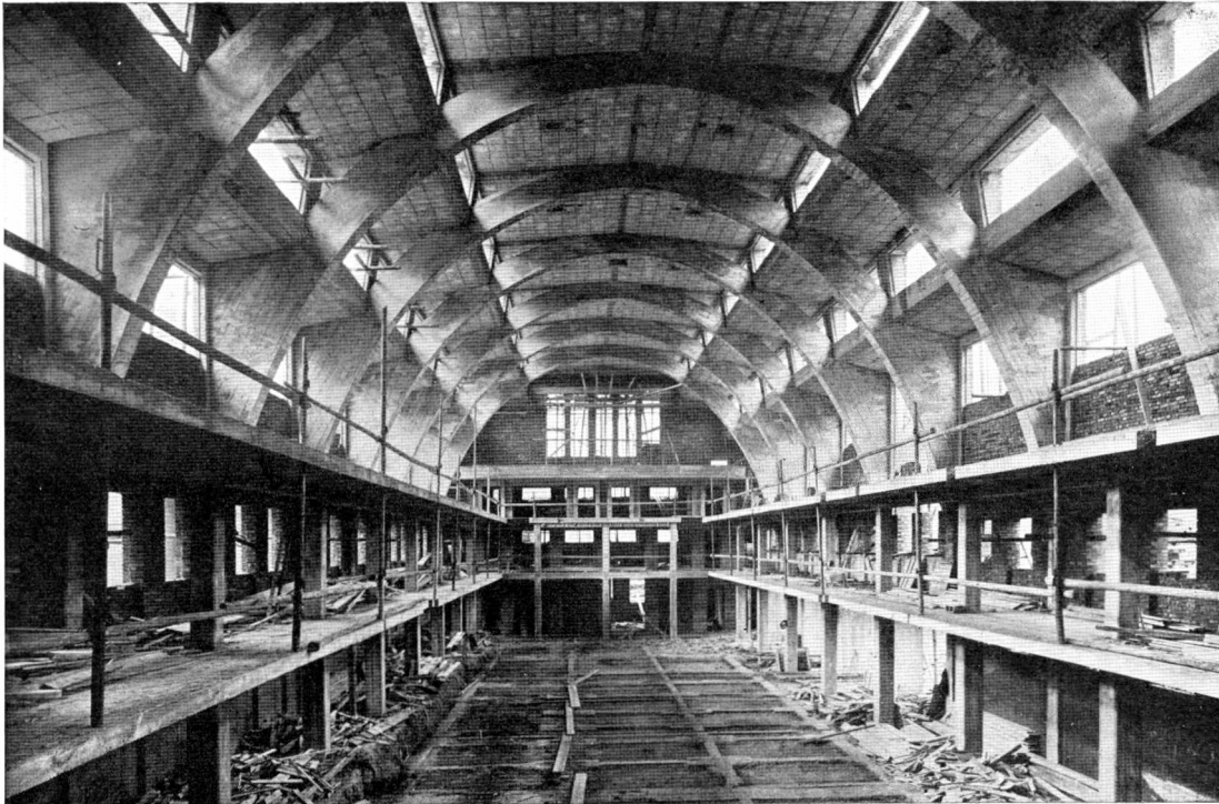
Abb. 97. Städt. Schwimmbad Stuttgart-Heslach. (Ed. Züblin & Co.). Die Schwimmhalle, nach dem Ausschalen Becken 600 m 2 , Scheitelhöhe über dem Wasserspiegel 10 m
