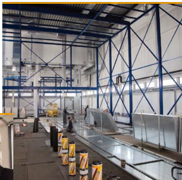
Drugiej takiej inwestycji próżno szukać w Europie – w budynku C-12 zaplecze badawcze Instytutu Telekomunikacji, Teleinformatyki i Akustyki, zbudowane pod konkretną instalację (sześć specjalistycznych komór, w tym dwie bezodbiłowe, i trzy pomieszczenia pomocnicze). Konstrukcja wewnątrz została złożona dosłownie w ciągu kilku dni. Trafiamy na koniec montażu podłogi (fot. powyżej). W maju nastąpi rozruch
