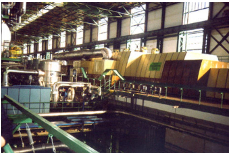
Turbozespoły w budynku maszynowni Elektrowni Bohunice
