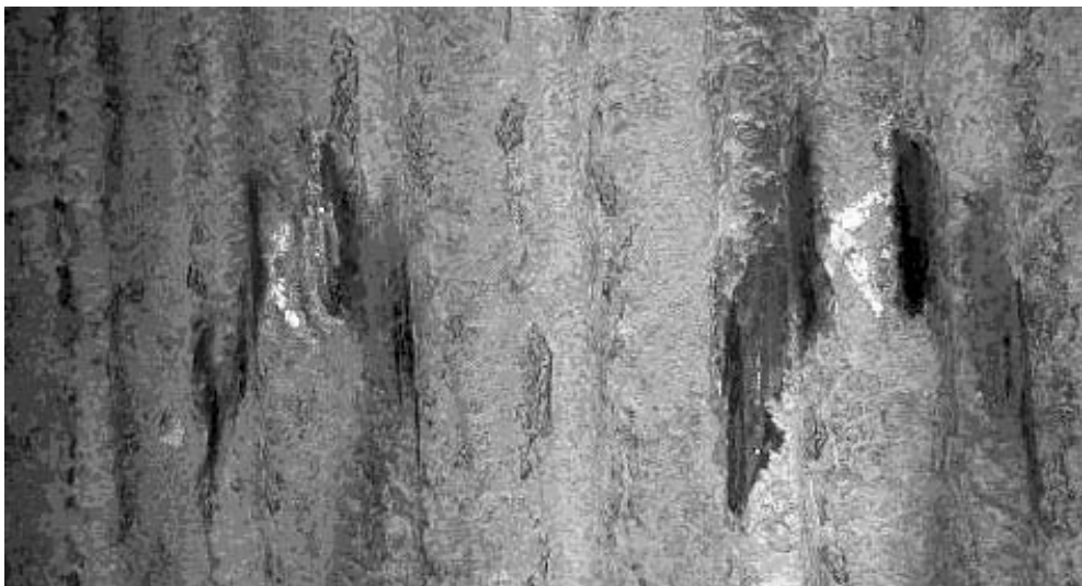
Rysunek 1.5: Czy skorodowana, metalowa płyta musi być już wymieniona ?
